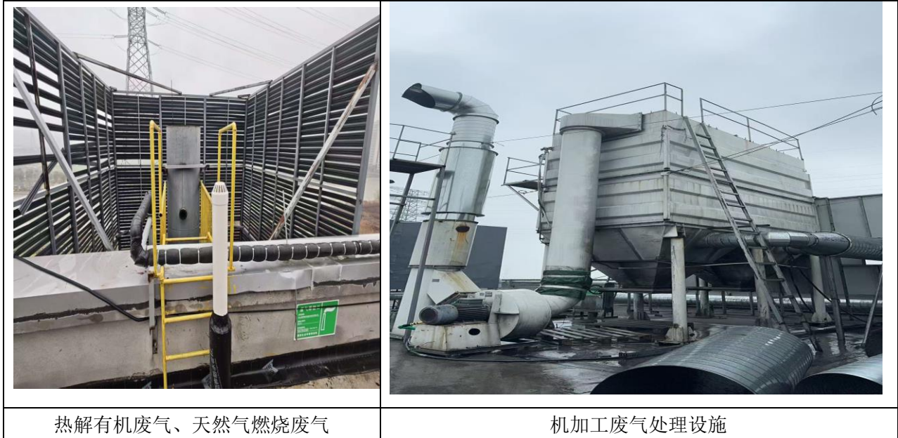
废气处理设施
